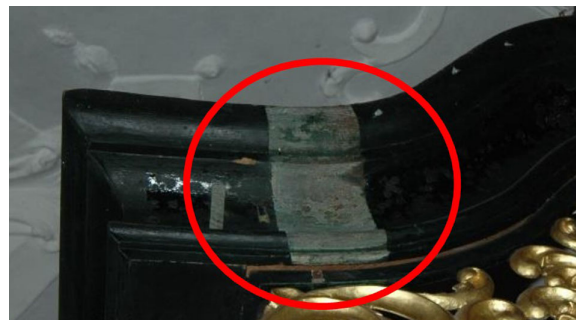
Abbildung 4: Pfarrkirche Roßbach, Befundbereich linker Seitenteil, Kranzgesims
